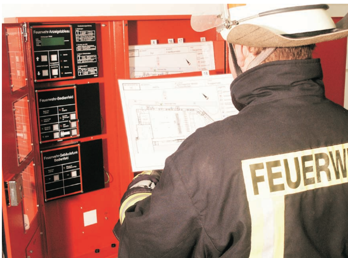
Hauptangriffspunkt der Feuerwehr bestehend aus FAT und FBF am redundanten Ringbussystem
